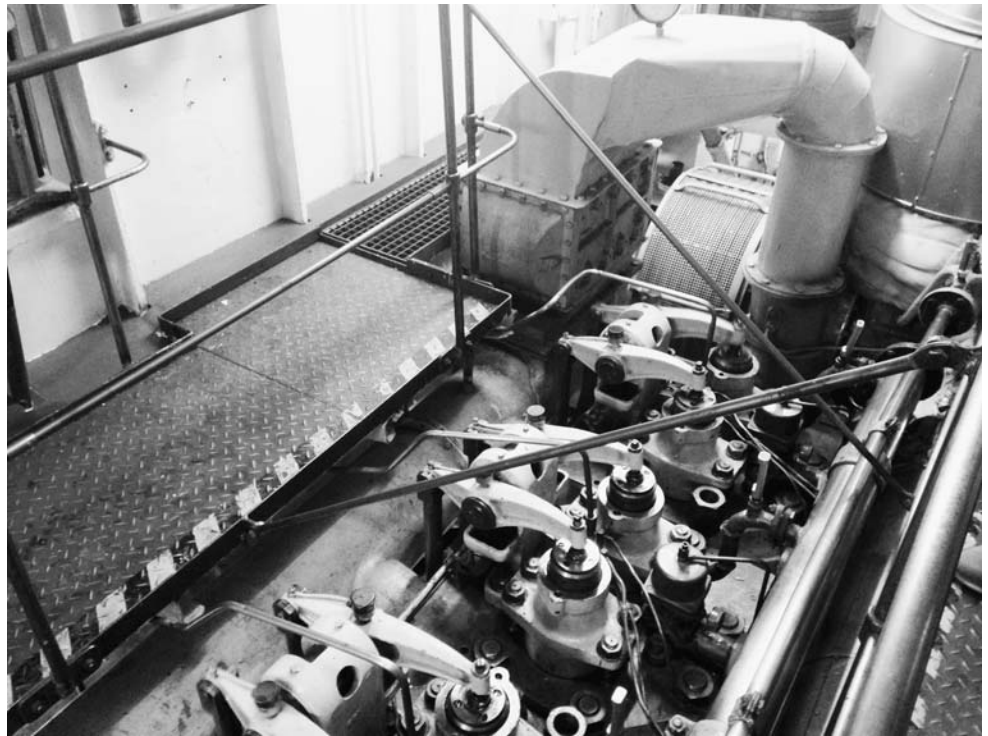
Der imposante Maschinenraum.
